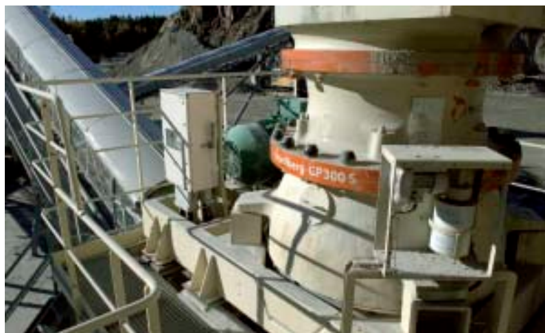
Beispiel für einen GP300S in einer stationären Anlage.
